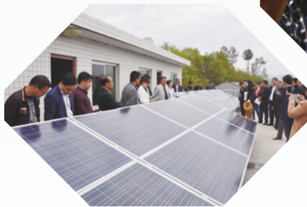
茨沟中心社区光伏发电
