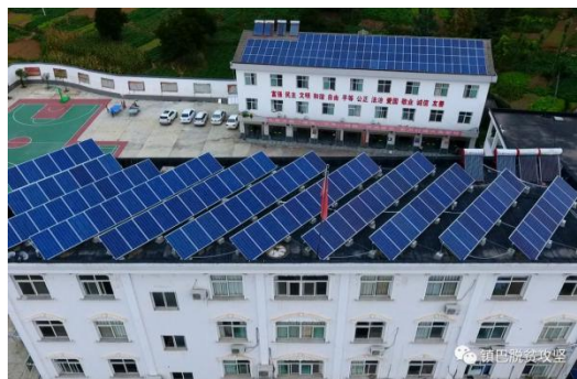
镇巴县首家 1 兆瓦光伏扶贫电站在黎坝建成发电
