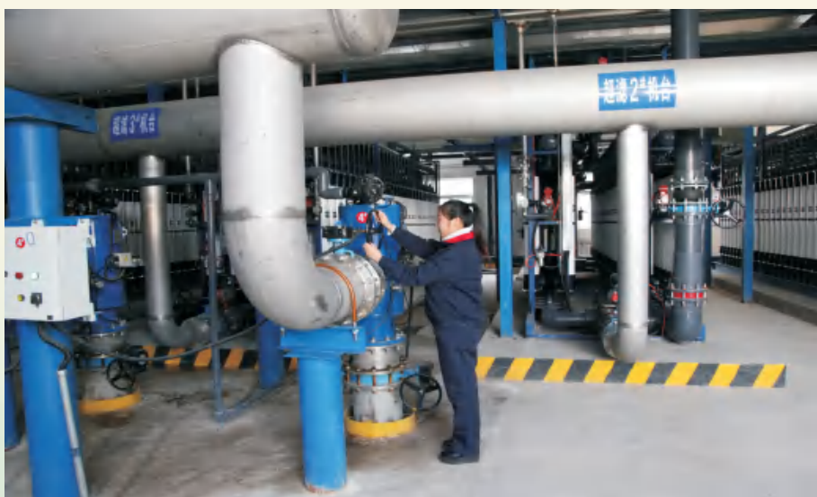
再生水厂正常运行
