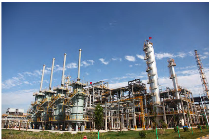
兴化集团乙醇生产设备
