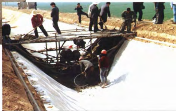
▲ 2000年灌区改造中，冯家山水利水电工程公司在南干渠进行弧底梯形渠道滑模施工
