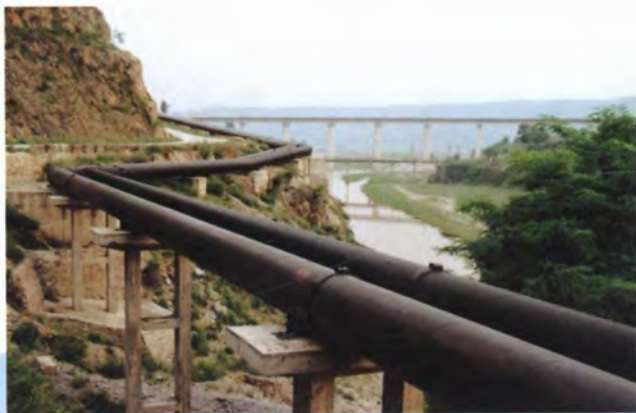
▲ 水库向宝鸡第二发电厂供水管道
