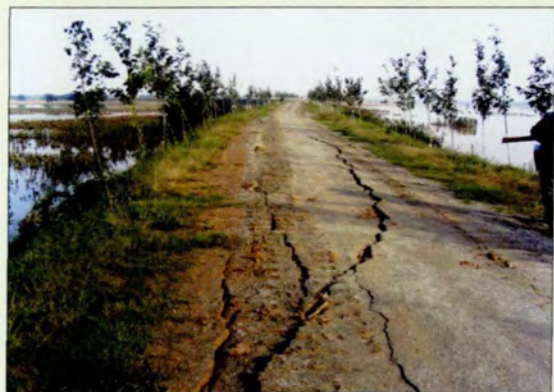
◆ 渭河防洪大堤多处裂缝
