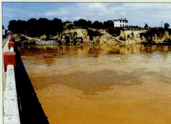
◆ 北洛河南荣华河岸滑塌
