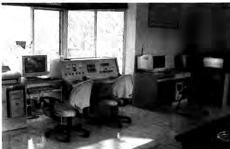
自动化监控室
