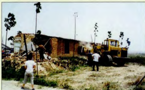
◆ 强行拆除违章建筑
