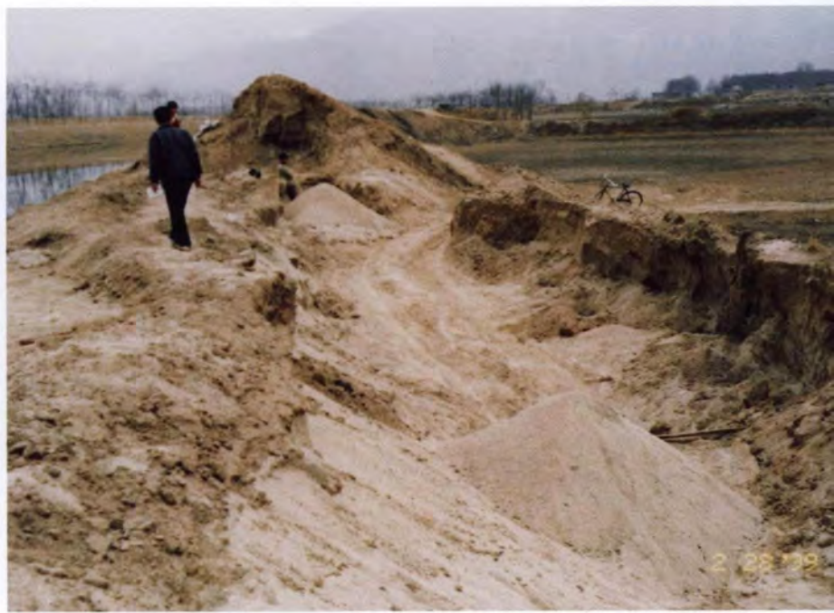
南山支流决口后暴露堤防内的砂子
