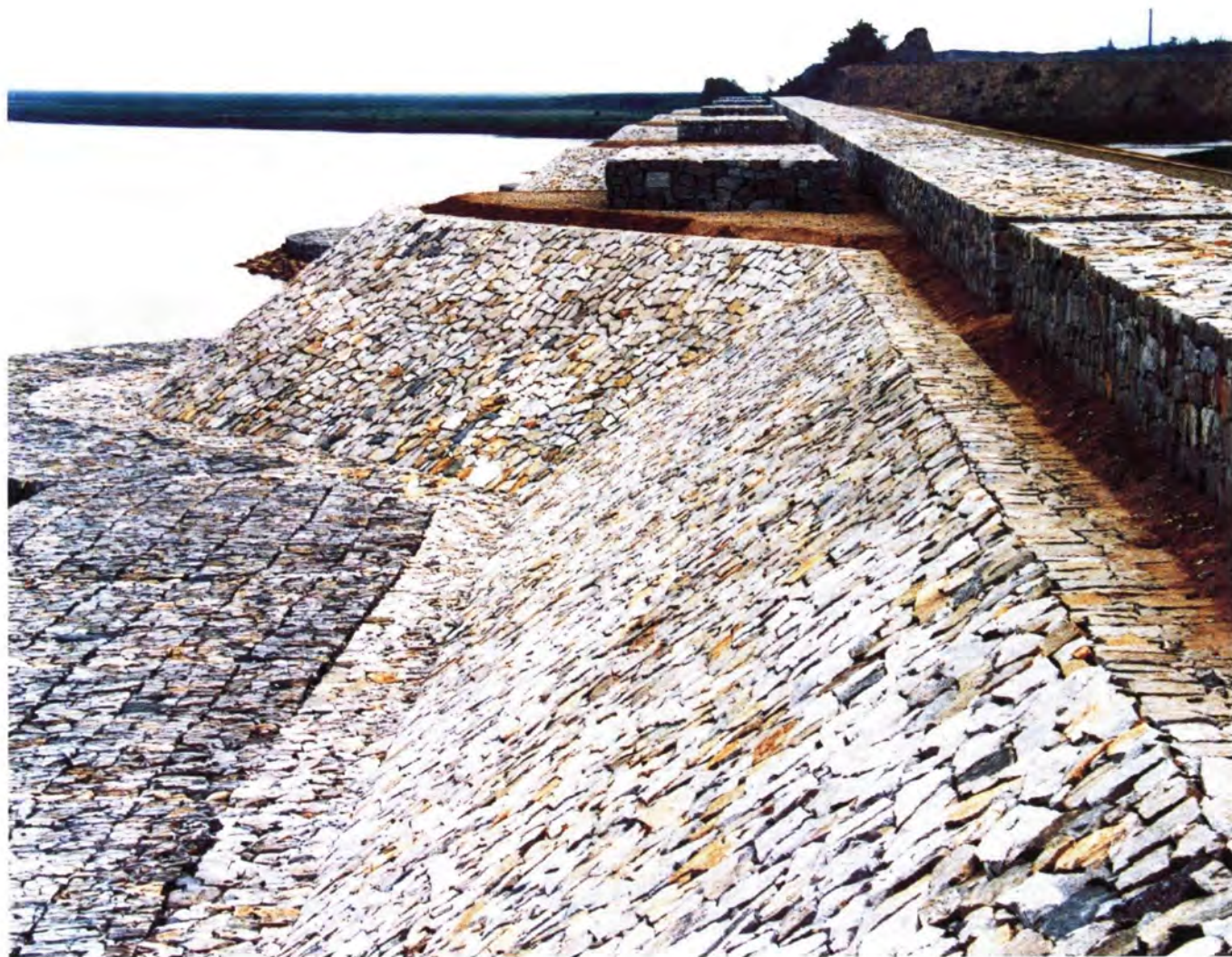
2004年7月，潼关吊桥险工。
