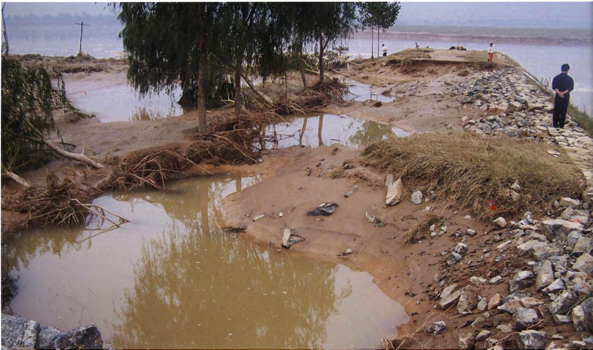
大荔新兴险工坝体损毁
