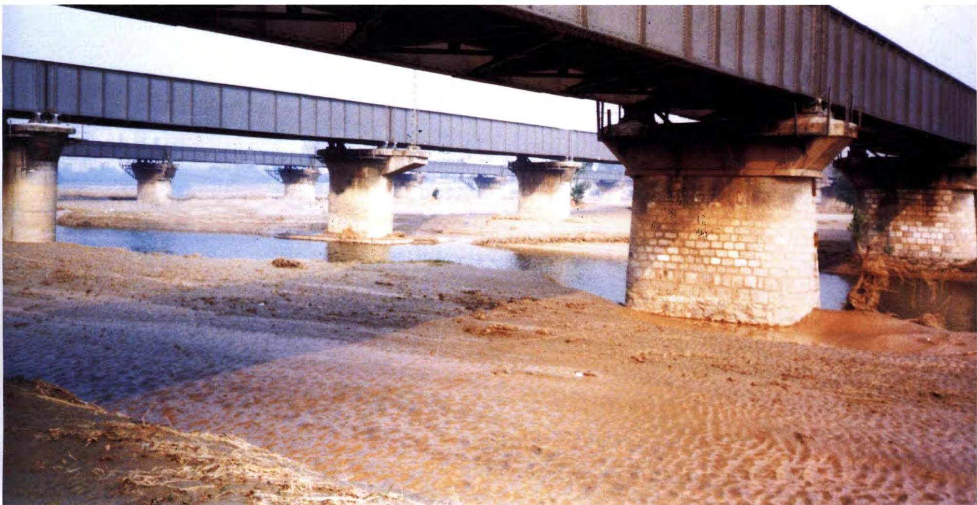
2003年，临潼新丰段西韩铁路桥下的淤积。
