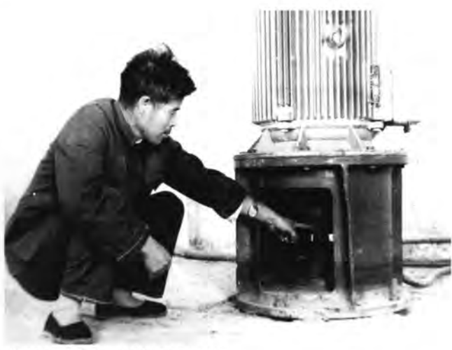
华县方山河排水站机组被淹
