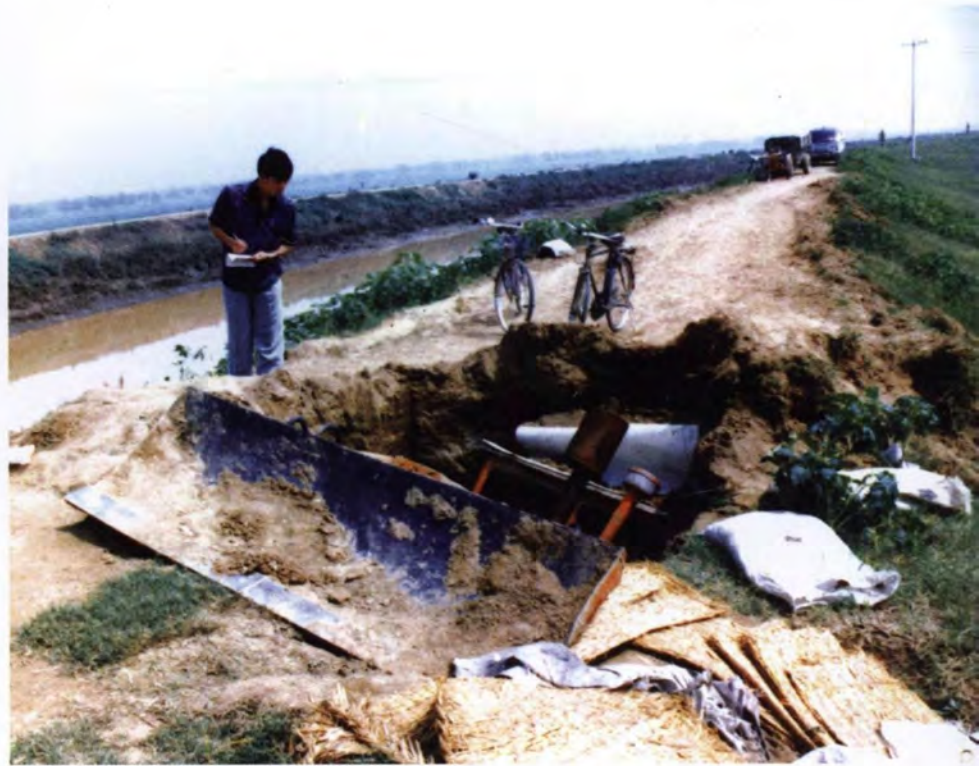
1998年7月13日，华阴柳叶河右堤5+260处堤防塌陷。
