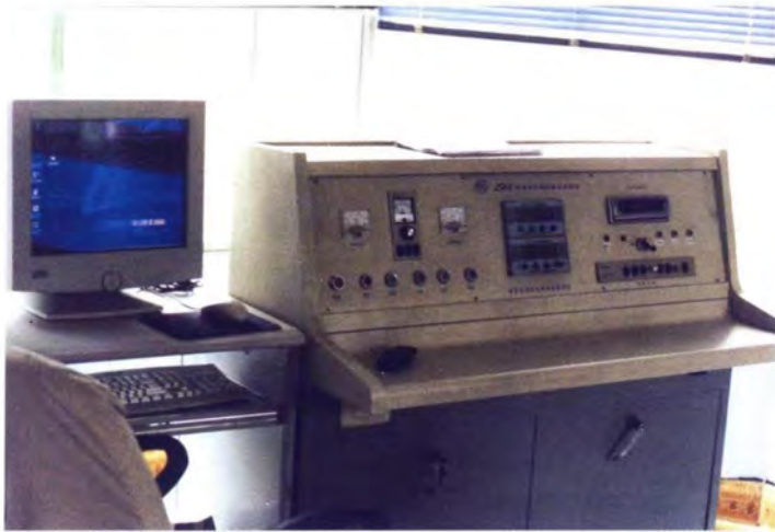
临潼水文站自动测报系统控制台
