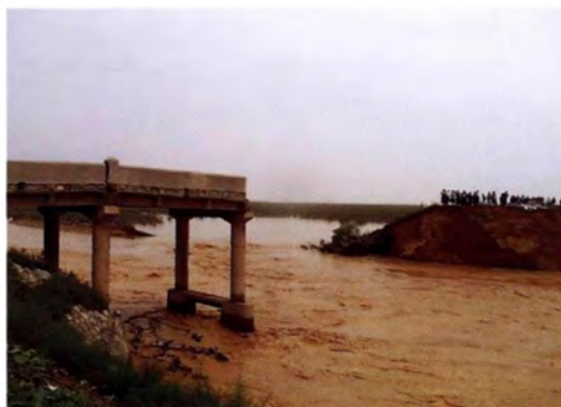
石堤河桥坍塌 (9月2日18时摄)
