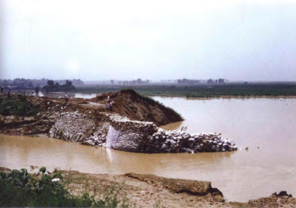
长涧河下游东西堤被洪水冲垮的情景
