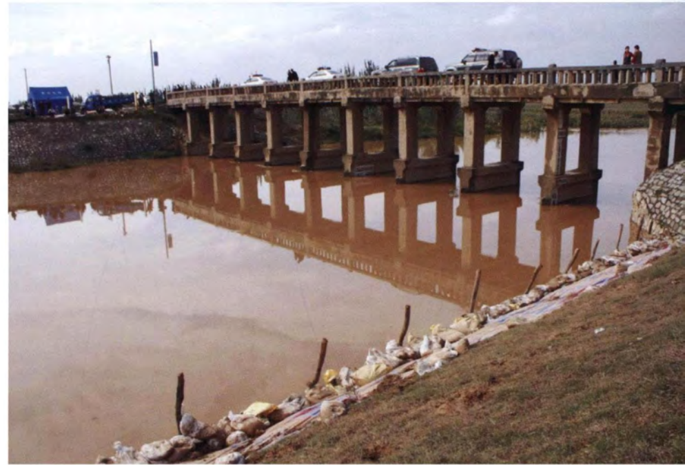
华县石堤河顶托的洪水位
