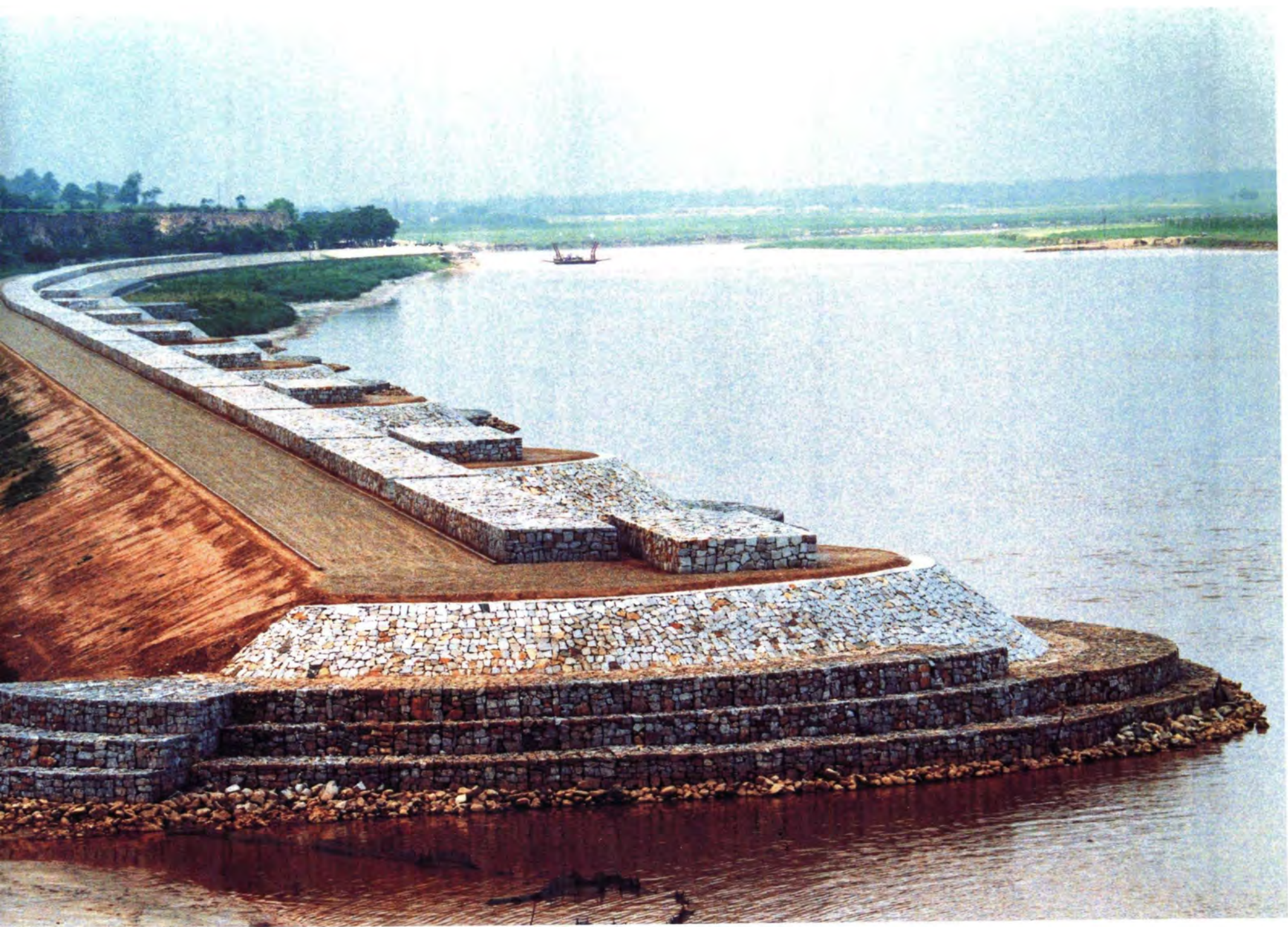
潼关吊桥险工
