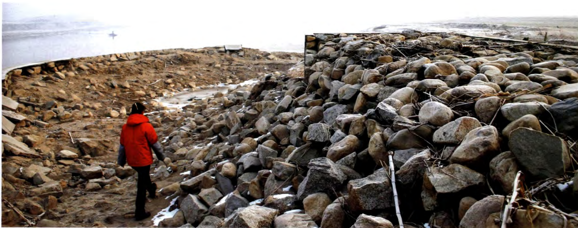
渭南临渭区梁村险工水毁
