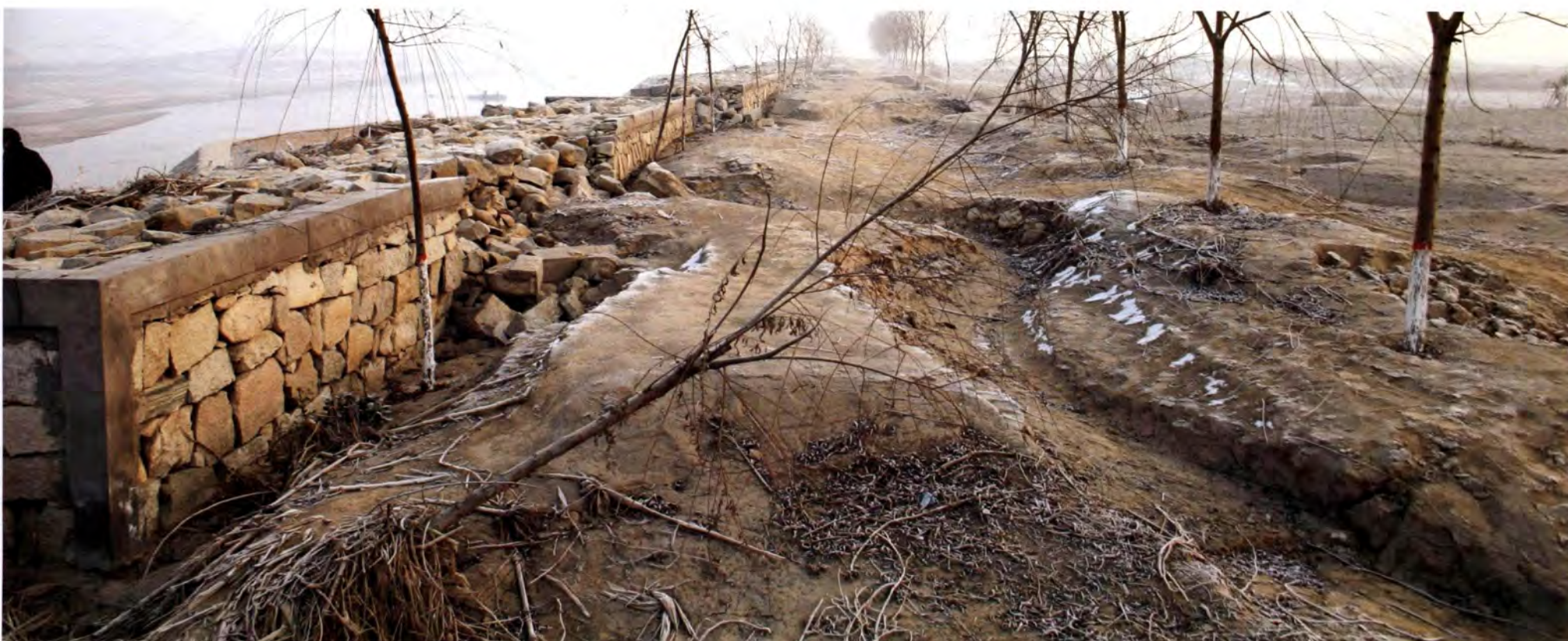
苏村24-25号坝连坝路水毁
