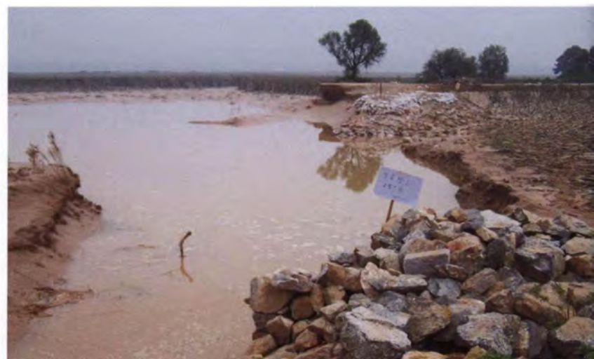
临潼席家险工15号水坝水毁
