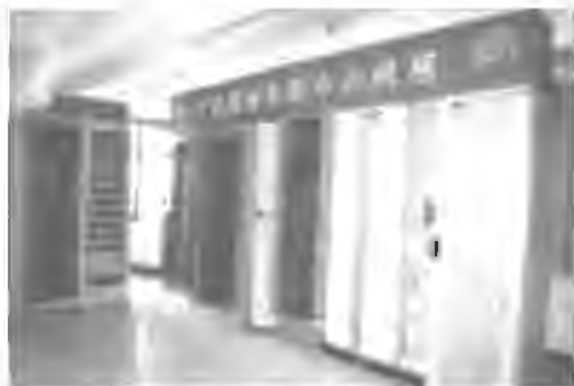
旬阳广电传媒支公司标准化机房
