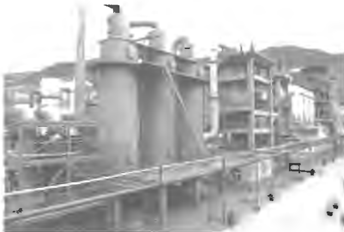
大地复肥有限公司废气制酸及余热利用系统
