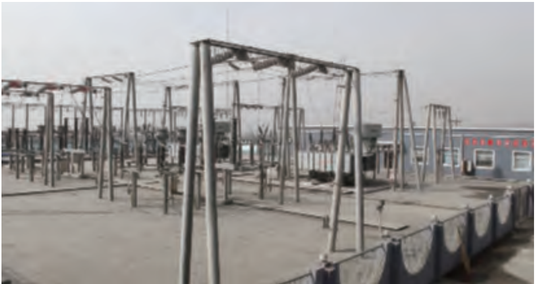
曹村镇义合110KV变电站
