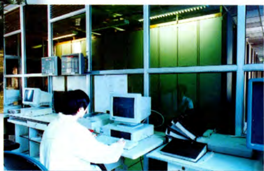
▲ 万门程控电话机房
