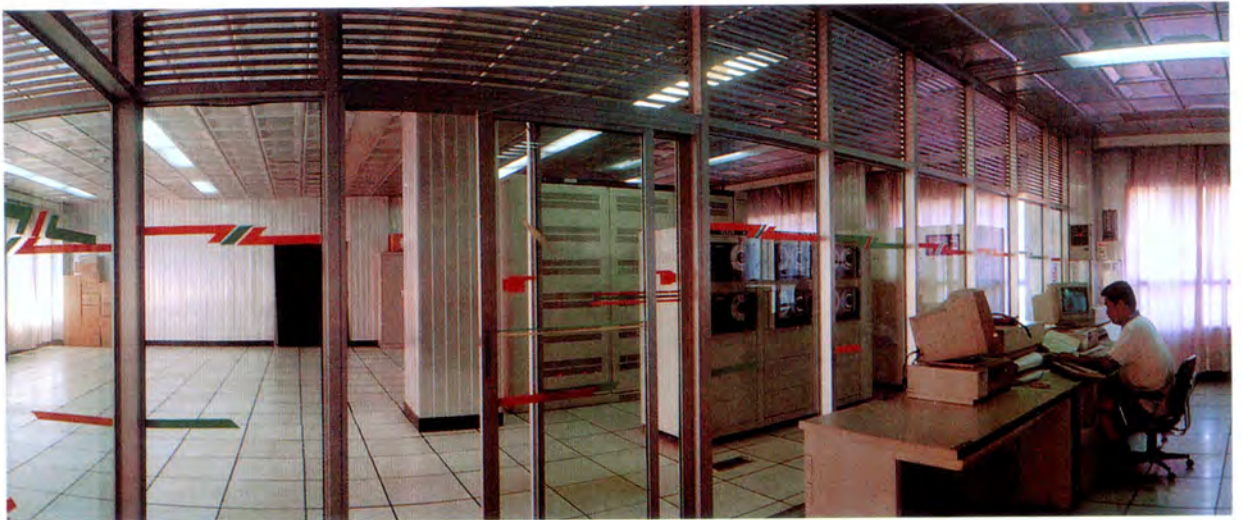
县邮电局万门程控电话交换机机房
