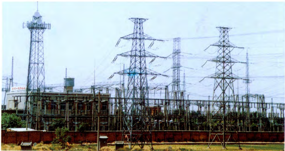
韦曲风栖原西 安南郊变电站
