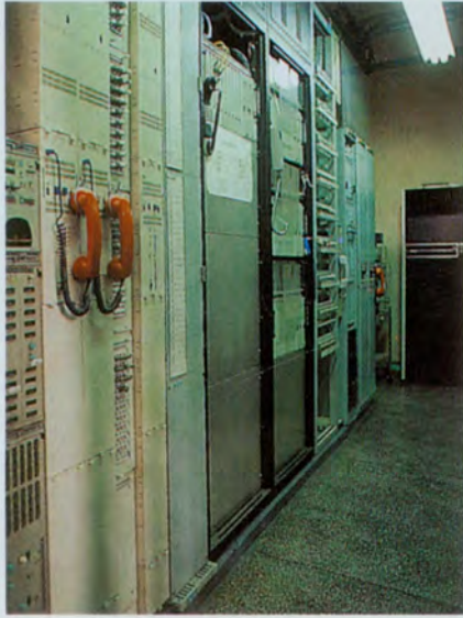
区邮电局程控机房
