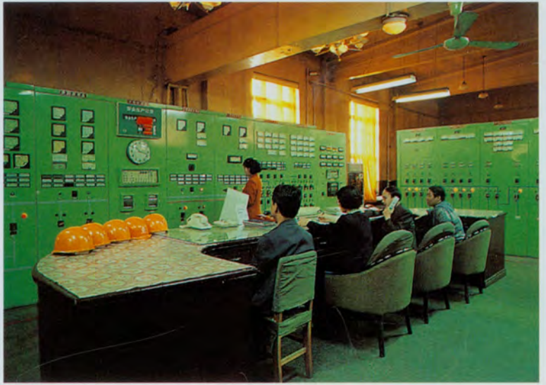
变电站控制室
