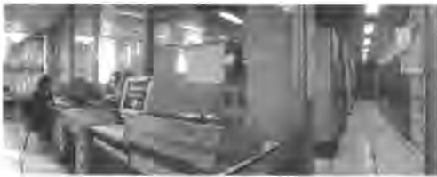
长途交换机房
