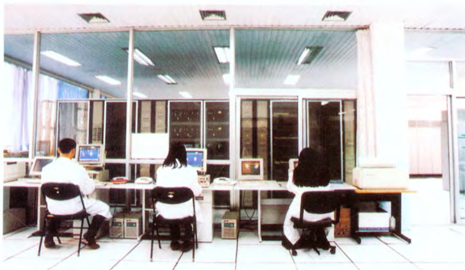
数据交换机房
