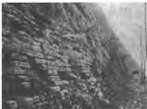
整修前北城墙外皮砖严重酥碱
