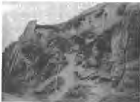
整修前南马道巷内侧塌方
