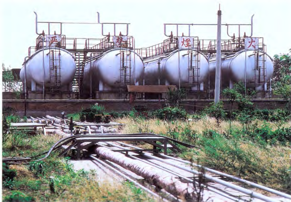
液化气罐装站
