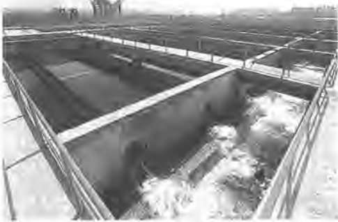
自来水厂斜管沉淀池
