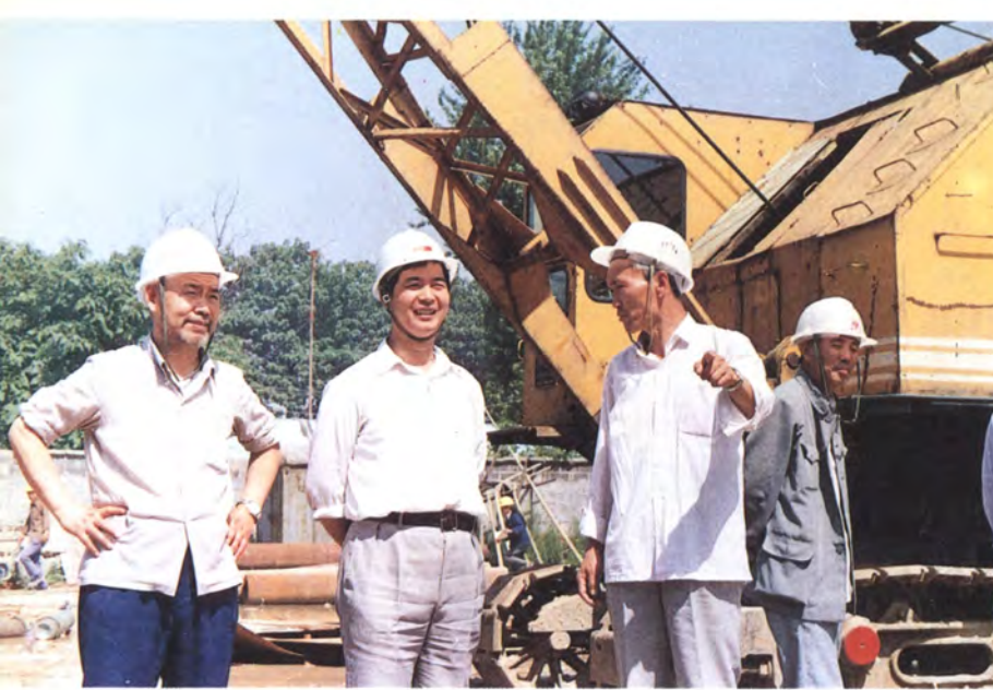
1990年,建设银行渭南地区中心支行领导在渭南热电厂了解施工情况。
