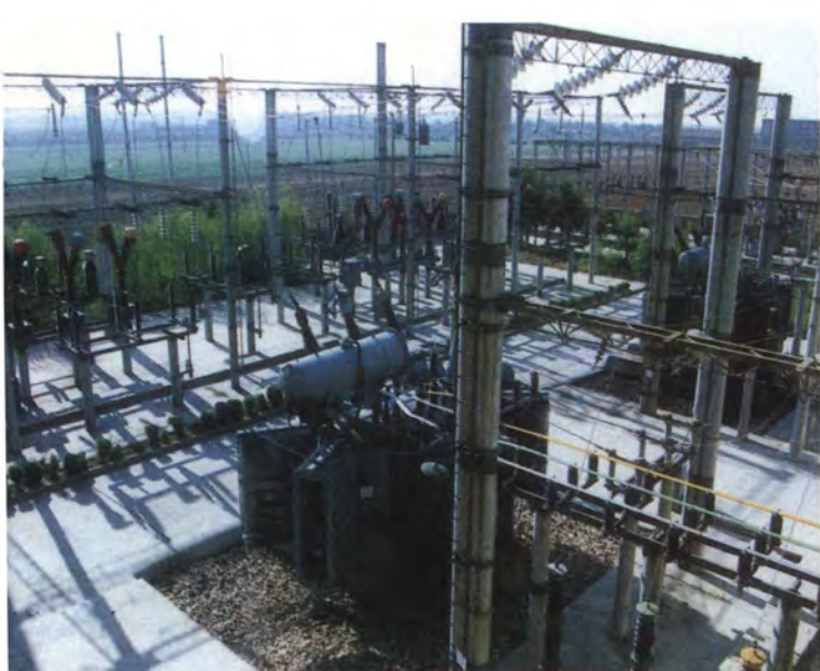
◁澄合矿务局东区变电所
