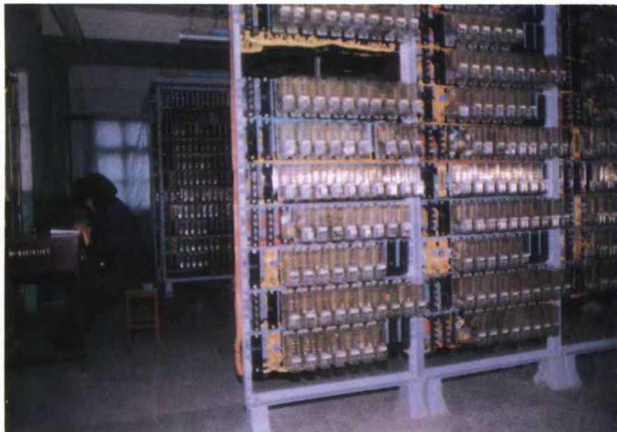
▷铜(川)—蒲(城)环线罕井车站信号机械室
