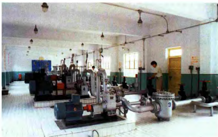
1991年建成的 西安·咸阳机场业 务油库油品收发泵 房一角。
