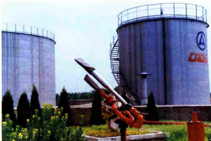
1991年建成的西安·咸阳机场油库灭火设备之一的消防炮。
