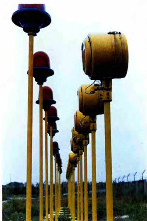
西安·咸阳机场跑道两端的助航灯光。
