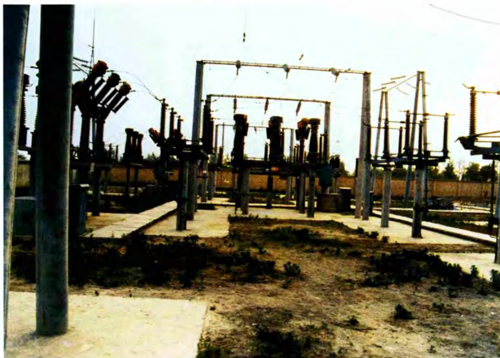
西安·咸阳机场一期建设中建成的机场变电站
