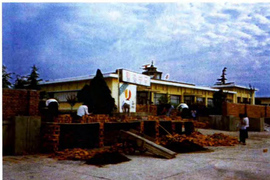
1991年9月2日，即西安机场关闭后的第二天，机场修建部门正在封堵候机楼与停机坪之间的通道。
