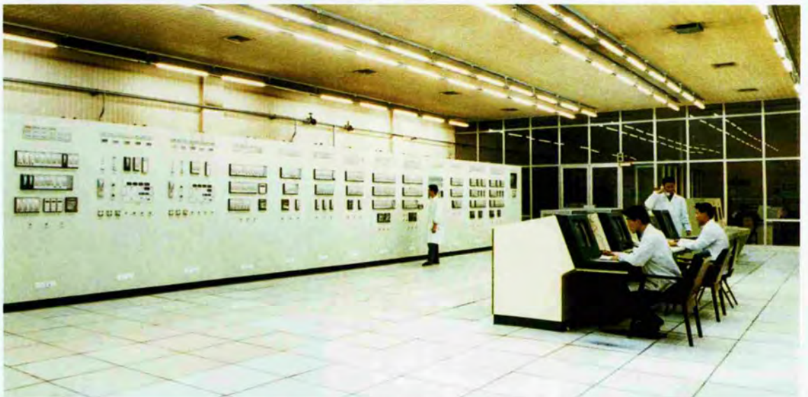
5号窑2000t/d熟料新型干法水泥生产线中央控制室
